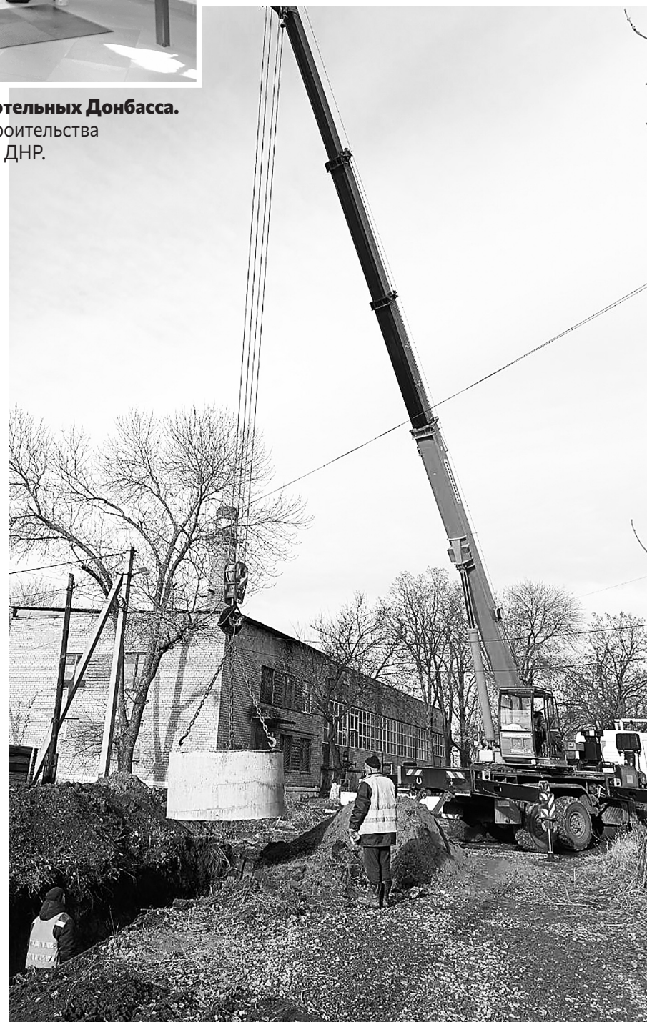
Предприятие «Вода Донбасса» проводит восстановительные работы в Пролетарском районе Донецка. Фото пресс-службы Министерства строительства и жилищно-коммунального хозяйства ДНР.
