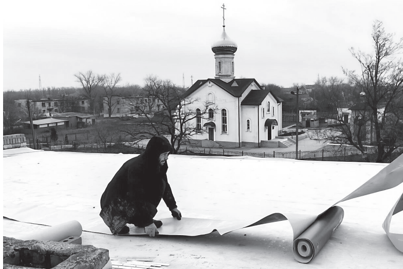
Крышу детского сада в селе Тополиное обновляют в рамках общей работы по восстановлению округа
