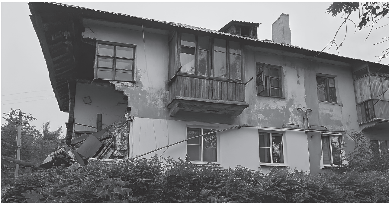
До конца 2026 года в ДНР расселят первые 16 аварийных домов. В очереди – ещё 863 многоэтажки
